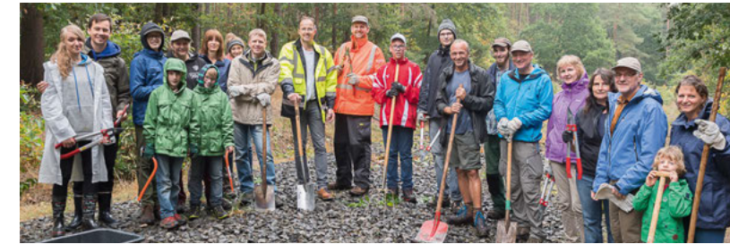
DB-Mitarbeiter packen mit an: Ende September greifen Eisenbahner-Familien aus Nürnberg, Berlin und Köln beherzt zu Hacke und Spaten. An einem regnerischen Samstag entfernen sie Büsche und Bäume und stellen neue Infotafeln auf.
